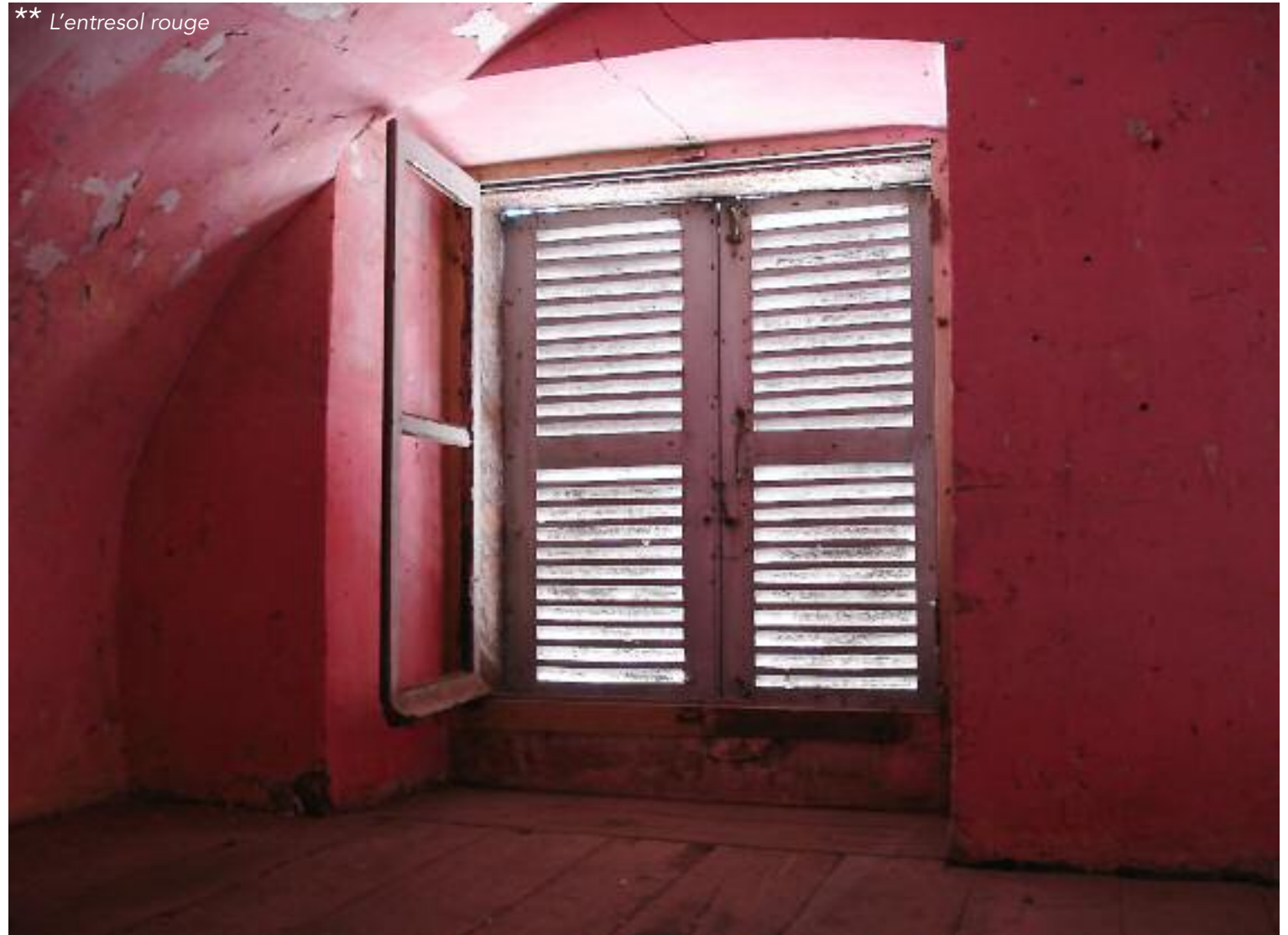
Entresol aménagé dans les voûtes du 1 er niveau sur rue. Il servait de logement aux agents de l'octroi. Au sol, plancher.
